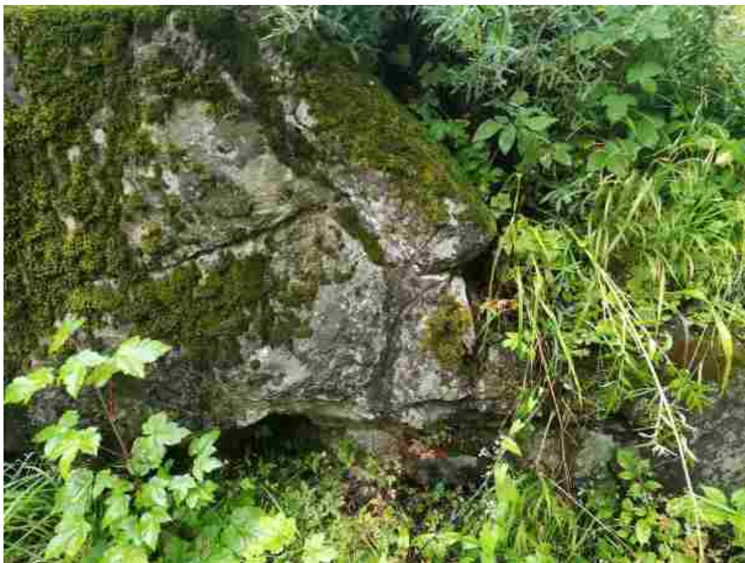
FOTOGRAFIA 7 USZKODZENIA KORPUSU ZAPORY.
